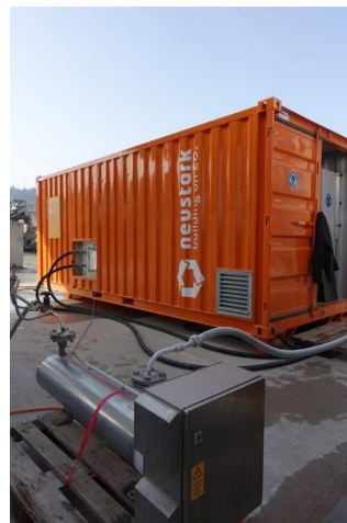
02_MPestalozzi_CO2SpeicherBeton ... und anschliessend zum Steuerungscontainer weitergeleitet. (3648x5472 Pixel)
