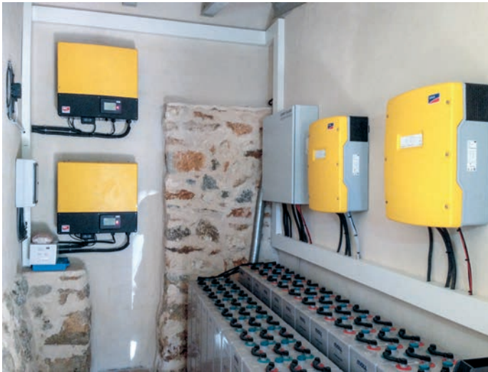
Photovoltaikstrom lässt sich in Batterien speichern.
